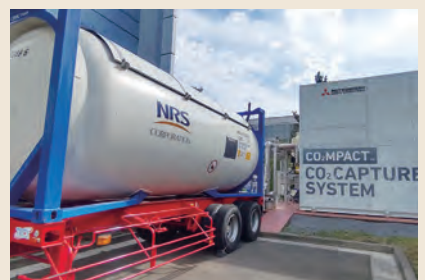
焼却工場のCO 2 回収(CCUの実証試験)
